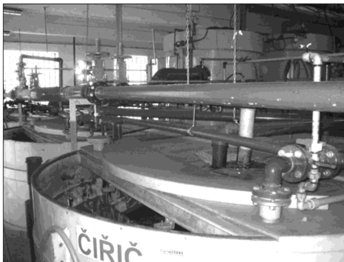
▲ Neutralizační stanice v provozu ŽDB
