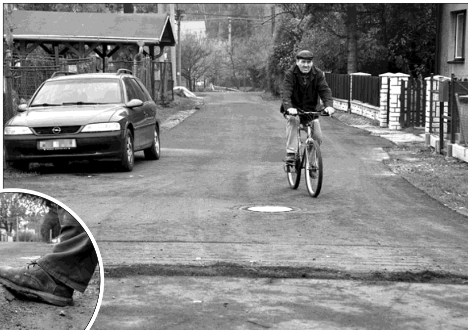
Úsek Staré ulice, která se napojuje na Sokolskou. Asfalt před domem pana Soukupa je o deset centimetrů výše než ten předchozí. Domkař má obavy, že mu před brankou bude stát voda. Foto: Pavel Čempěl
