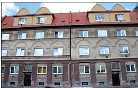
Neutěšený stav fasády trojbloku v Husově ulici krátce před rekonstrukcí. Foto: Pavel Čempěl
