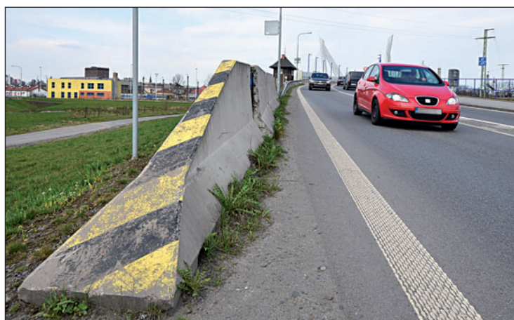
Betonová svodidla měla být u mostu dočasně, zůstala však čtyři a půl roku. Foto: Pavel Čempěl
